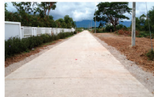
โครงการก่อสร้างถนนคอนกรีตเสริมเหล็ก ภายในหมู่บ้าน ซอย 8 หมู่ที่ 5
