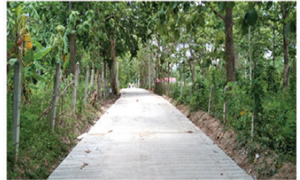
โครงการก่อสร้างถนนคอนกรีตเสริมเหล็ก ซอยบ้านนางบังอร หมู่ที่ 15 บ้านเกษตรสุข
