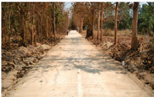
โครงการก่อสร้างถนนคอนกรีตเสริมเหล็ก ทางเข้าวัดเกษตรสุข หมู่ที่ 15
